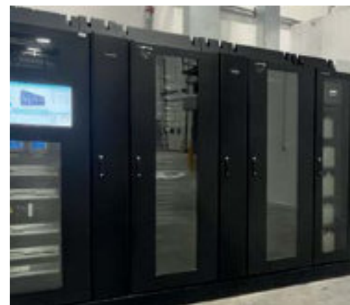
The mini data centre on the first floor
